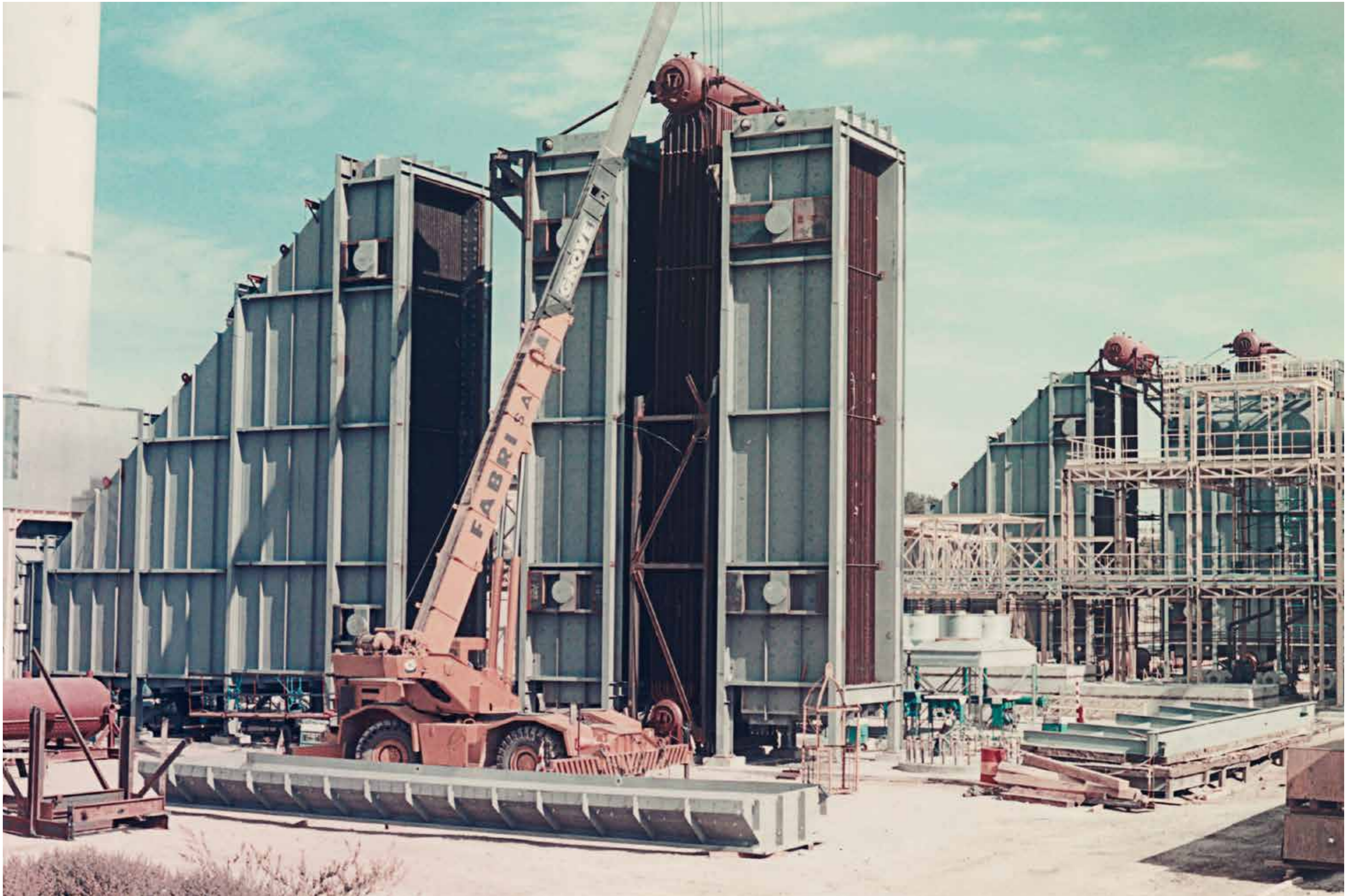
INGENIERÍA, FABRICACIÓN Y MONTAJE DE 2 CALDERAS DE RECUPERACIÓN, HRSG, ALUAR, CHUBUT - FOSTER WHEELER
