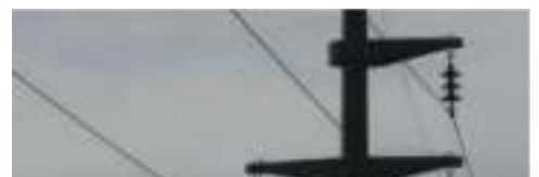
Líneas de media y baja tensión — EPE
